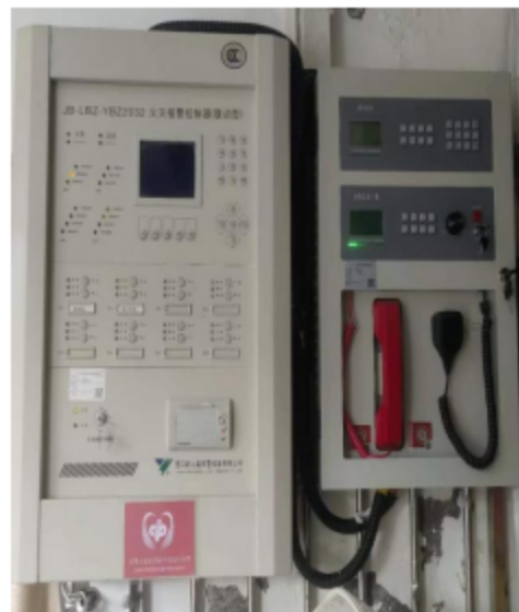
（更换后消防喷淋系统控制柜）
