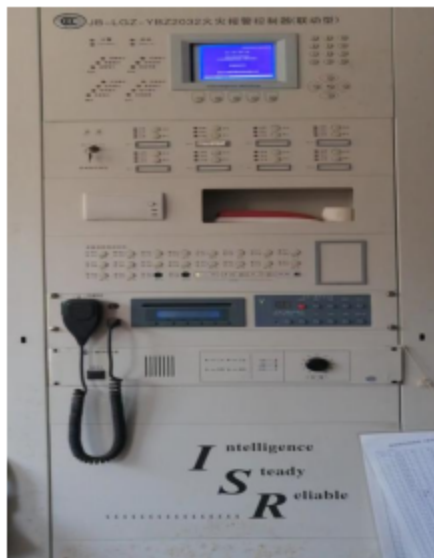
（旧消防喷淋系统控制柜）
