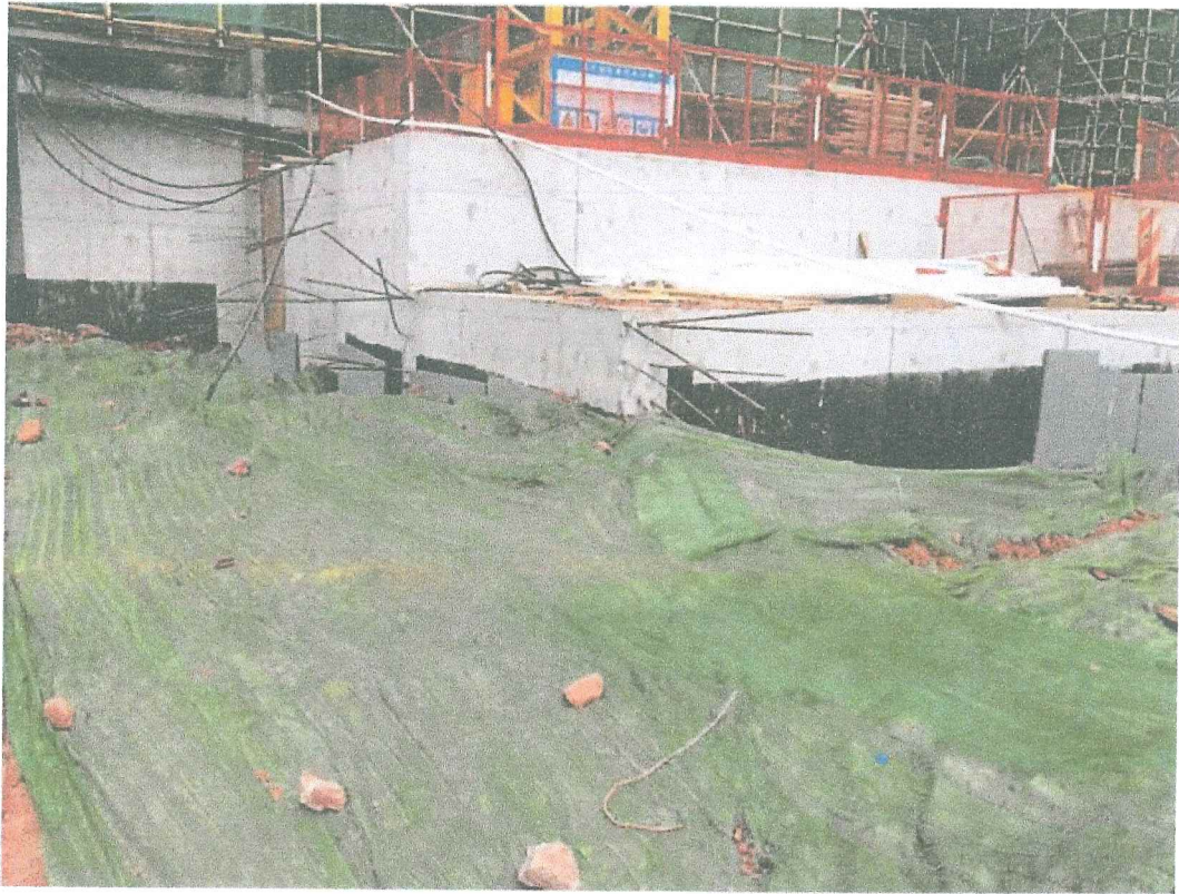
加强裸土覆盖面积(整改后)
